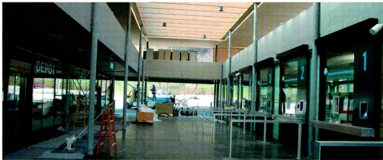
Transparent präsentiert sich die Rosenalmbahn-Talstation (oben). Der Kassabereich der Horbergbahn (unten) ist nun überdacht. Foto: Döllinger
